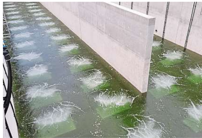
So sah es aus, als die Belebungsbecken noch nicht voll waren. Hier ist die wohl dosierte Sauerstoffzufuhr zu erkennen.
