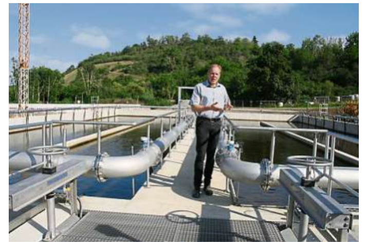
Die beiden Belebungsbecken sind in Betrieb, zeigt Matthias Fink, Geschäftsführer des Kläranlagenbetriebsverbands.
