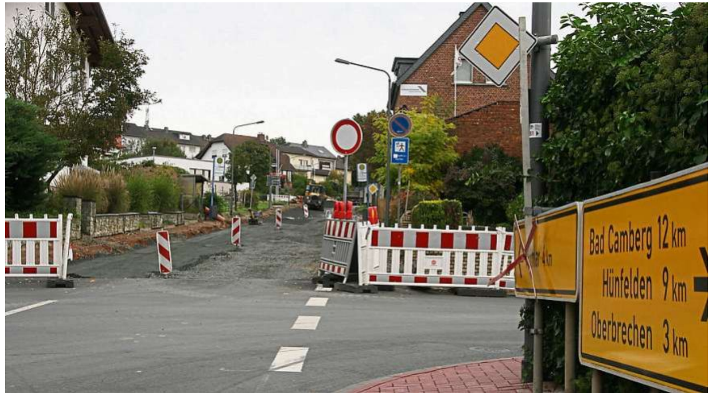
Bis zur Bachstraße ist die Villmarer Straße von der B 8 in Niederbrechen kommend wieder befahrbar, dahinter noch Baustelle. Bis zum Jahresende soll alles fertig werden – früher als geplant.
